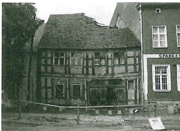
Foto 1: Verfallenes Fachwerkhaus in Friesack/ Brandenburg
